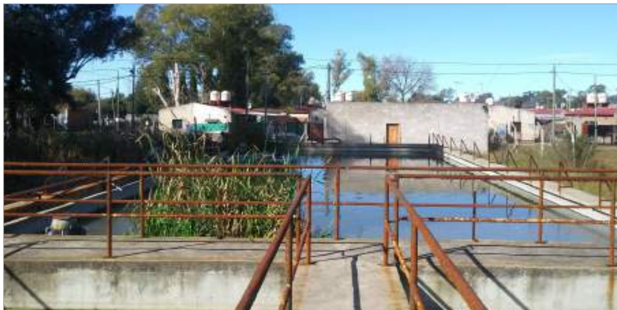
Imagen 3 - Planta de tratamiento de efluentes Fotografía realizada y autorizada por miembros del Vector de Integración de Barrios Populares (FIUBA)
